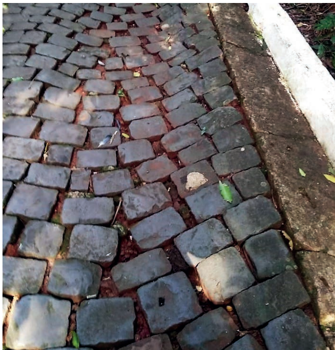
Figura 45. Revestimento em paver de paralelepípedo, com fendas entre as peças. Fonte: Trabalho de campo (2020).
