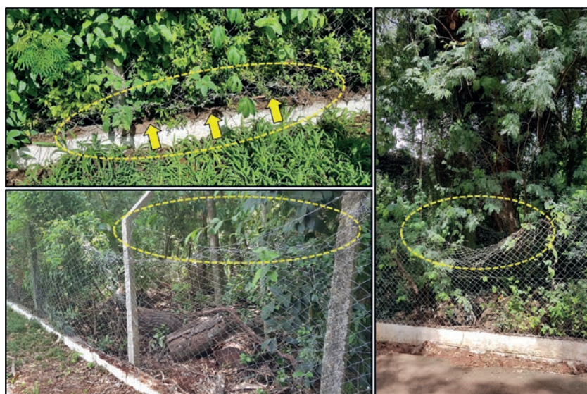
Figura 158. Cercado do Parque do Ingá, com destaque às áreas da grade deterioradas pela ação da queda de galhos e árvores, além da ação de vandalismo. Fotos: Tófoli (2019).
