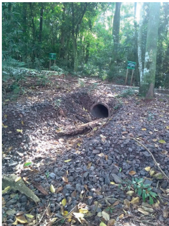
Figura 48. Ponto de descarga e escoamento de água pluvial com presença de “rachões”. Fonte: Trabalho de campo (2020).
