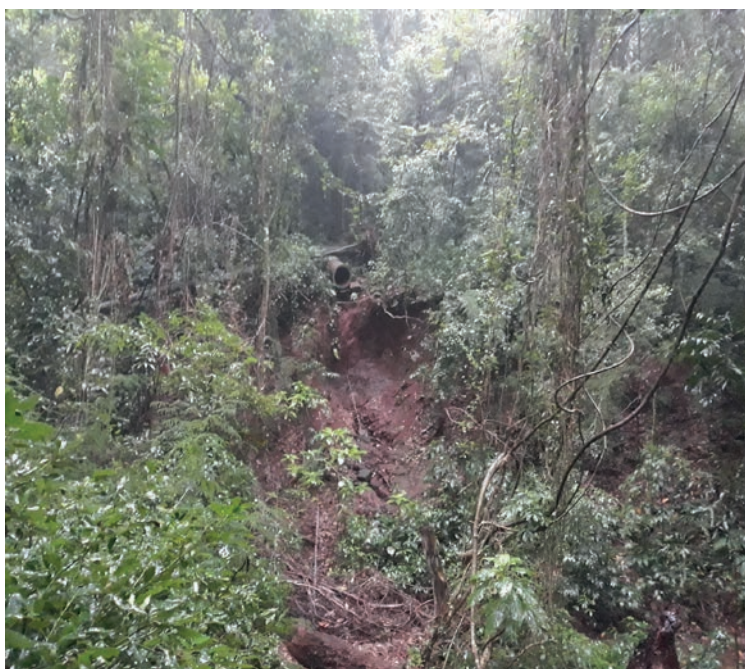
Figura 41. Formação de feição erosiva ao final das galerias, a jusante do lago artificial. Fonte: Trabalho de campo (2019) - Akilis R. Hespanha.
