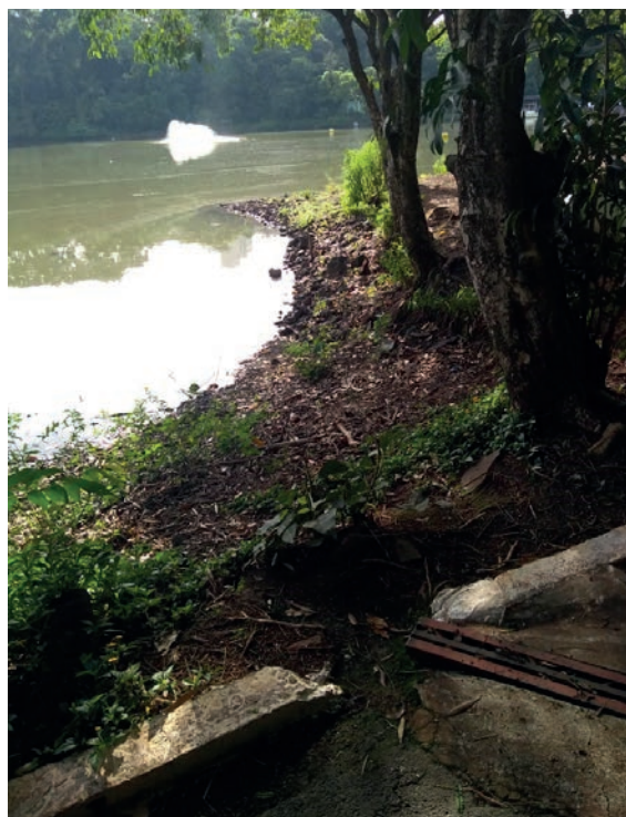
Figura 47. Borda do lago do Parque do Ingá com a presença de “rachões” para contenção de erosão marginal. Fonte: Os autores (2020).
