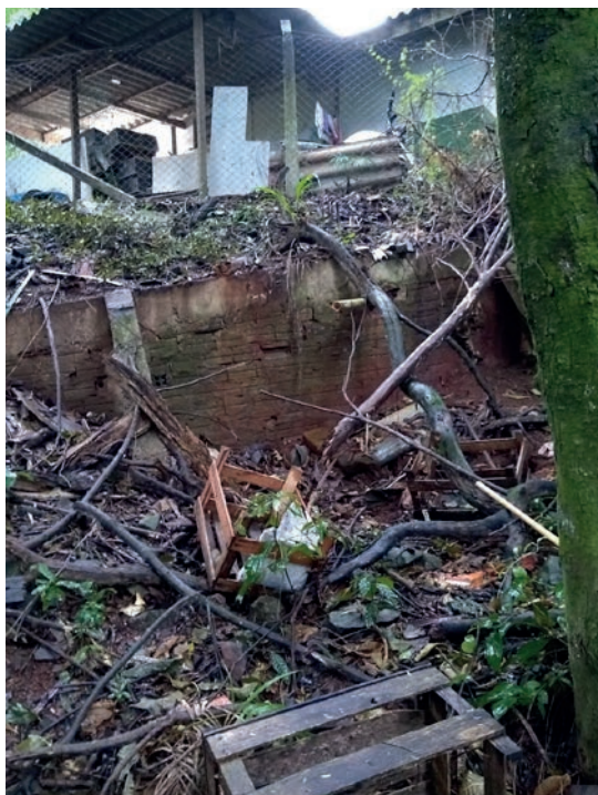
Figura 39. Início de sulcos erosivos abaixo das tubulações instaladas em área construída. Fonte: Trabalho de campo (2019) - Akilis R. Hespanha.
