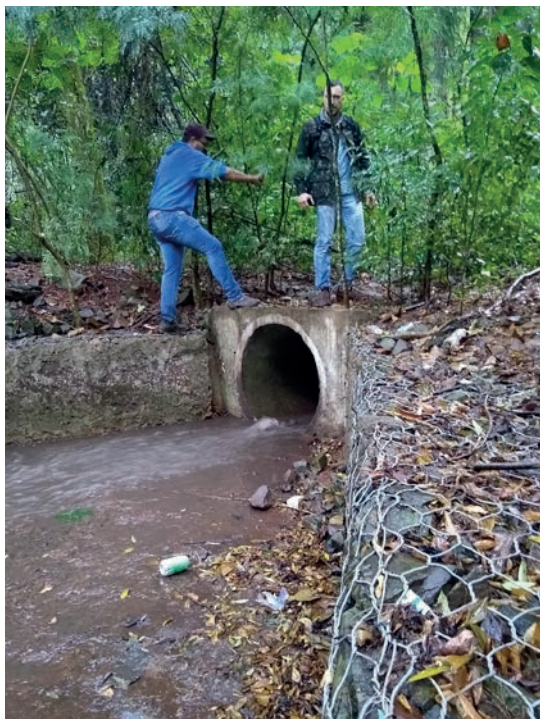
Figura 38. Área sem indícios de erosão e gabião em boas condições de funcionamento. Fonte: Trabalho de campo (2019) - Akilis R. Hespanha.
