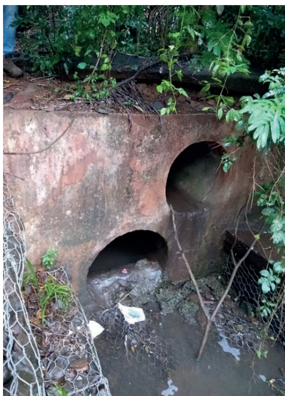
Figura 36. Duas saídas de galerias pluviais no início do canal artificial Leste. Fonte: Trabalho de campo (2019) - Akilis R. Hespanha.
