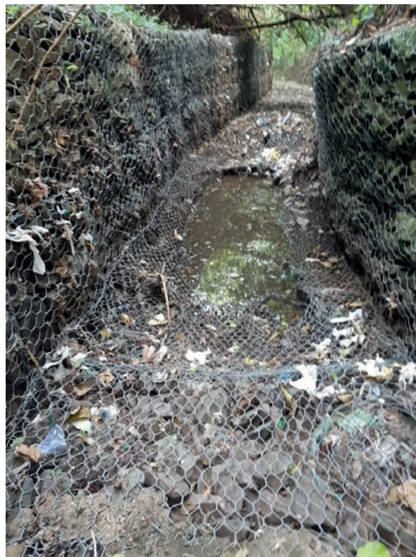
Figura 32. Detalhe do gabião no canal artificial Leste, que necessita de monitoramento. Fonte: Trabalho de campo (2019) - Lucas C. F. Sant'Ana.
