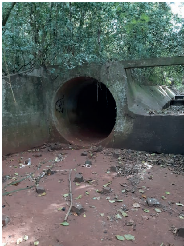
Figura 26. Saída do coletor das vias públicas da Zona 1 e Zona 2 de Maringá. Fonte: Os autores (2019).
