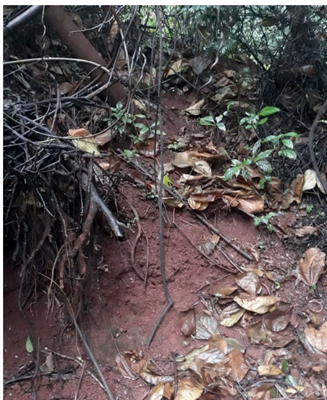
Figura 37. Erosão marginal, paralela ao talude de gabião do canal artificial. Fonte: Trabalho de campo (2019) - Akilis R. Hespanha.
