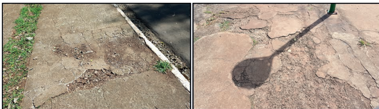
Figura 159. Trechos pontuais nos quais há deterioração da calçada na área de entorno do Parque do Ingá. Fotos: Tófoli (2019).
